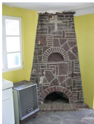
Cheminée de la cuisine.
